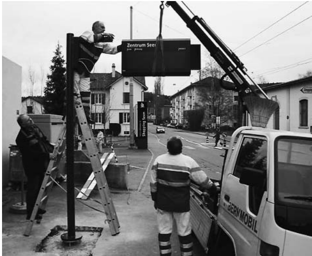
Installation der SmartInfos: Abfahrtsanzeigen verbessern Fahrgastinformationen.
