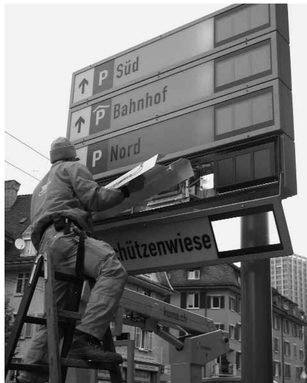
Installation des neuen Parkleitsystems
