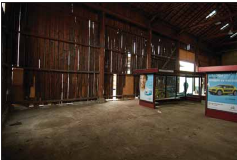
Die Holzverkleidung der Halle ist in einem sehr schlechten Zustand. Die ausgedienten Bushäuschen werden als Unterstand in der Anlage wieder verwendet.
