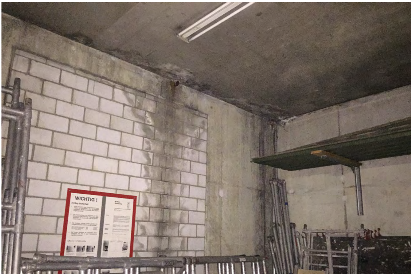
Werkstattgebäude, Untergeschoss, Schnittstelle zum Gebäude Nebenbetriebe; defekte Dilatationsfuge
