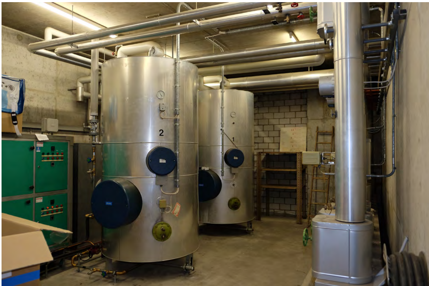
Werkstattgebäude, Untergeschoss; Heizung / Lüftung
