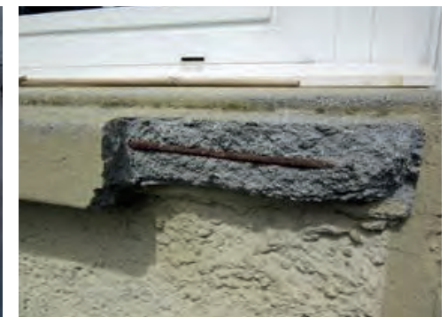
Kunststeinfensterbank mit Fehlstelle
