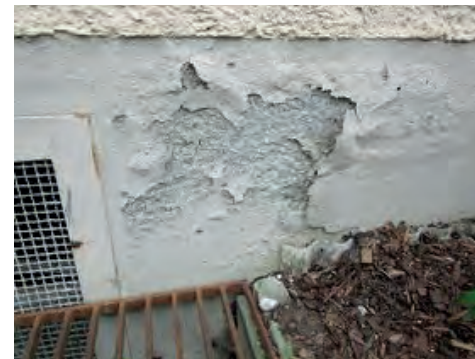
Schadstelle im Sockelbereich und Schalenbildung
