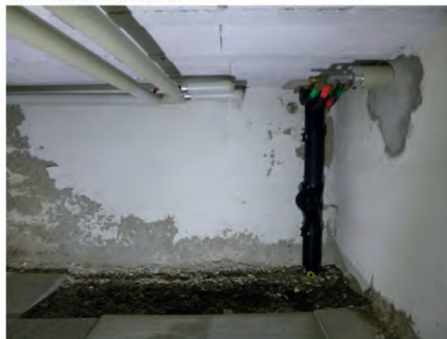
Grabenacker 29, Keller Fernwärmeheizung und neuere Leitungen kein Asbestverdacht
