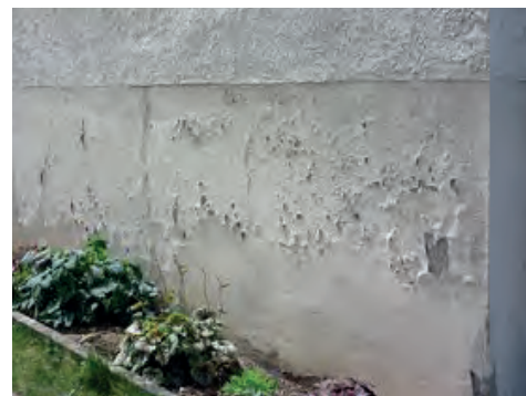
Anstrichablösung im Sockelbereich
