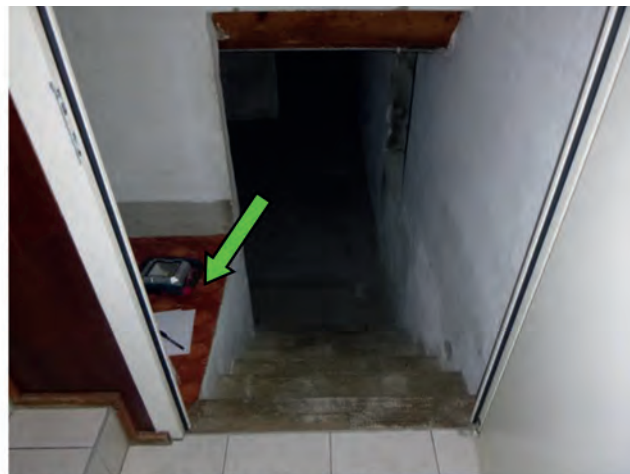
Grabenacker 29, Eingang Keller Kunststoffbelag neueren Datums ohne Kleber, kein Asbestverdacht
