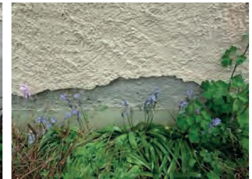
Verputzschäden oberhalb des Sockels
